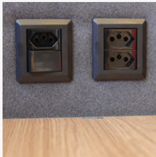
Sistema de conectividade
